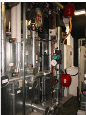
Lüftungs-/Kältezentrale in kompakter Anordnung
