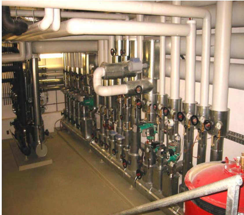
Zentrale WW- / KW-Verteiler
