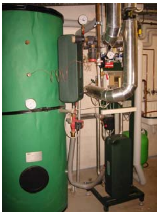
Warmwasserbereitung mit Legionellenschutzschaltung
