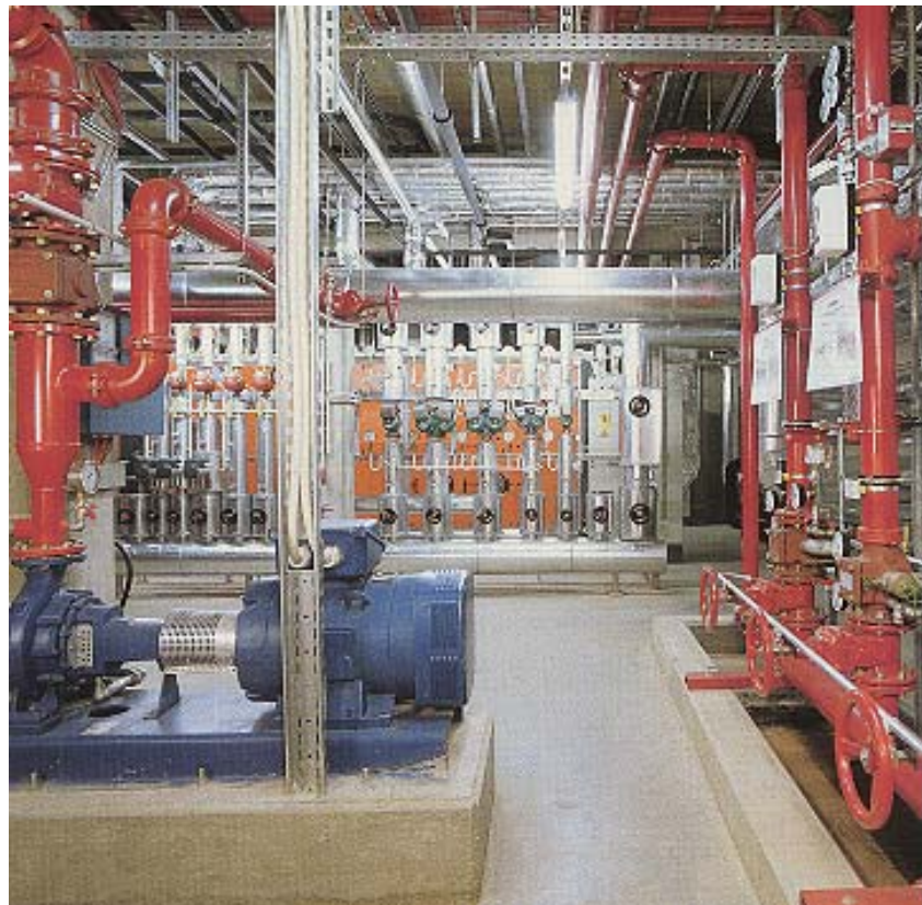
Das Herzstück der Heizungs-, Lüftungs- und Kälteanlage: Die Zentrale im KG
