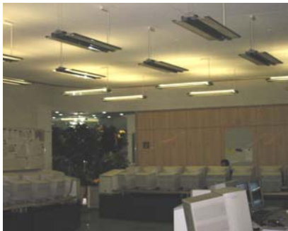
Bildschirmgerechte Arbeitsplätze in der Leitwarte des Kontrollhauses. Ausgerüstet mit einer kombinierten Kühl- und Heizdecke.
