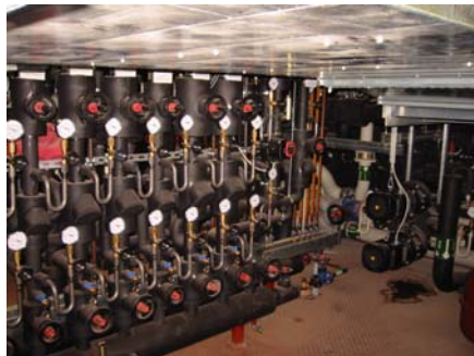
Die Zentrale der Heizungs-, Lüftungs- und Kälteanlage.
