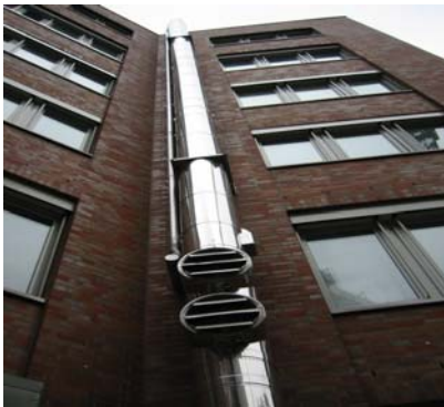
VA-Rohrsystem Anlage Küche
