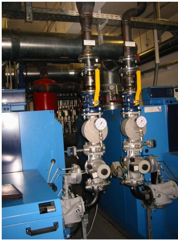
Gasheizkessel mit Gas-Regelstrecke und Schalldämmhauben
