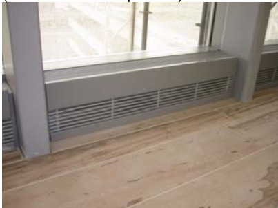
Konvektor in Nischenverkleidung
