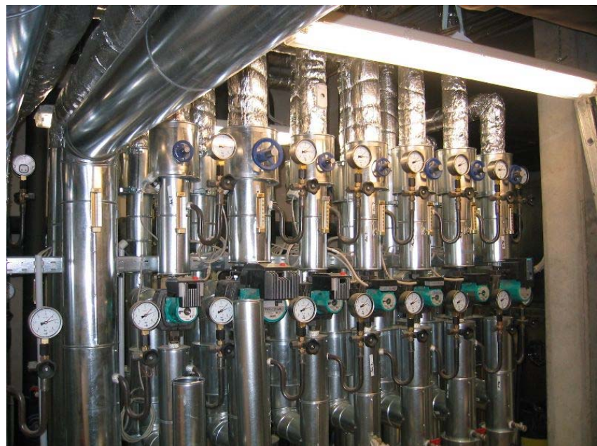
Verteiler in der Zentrale
