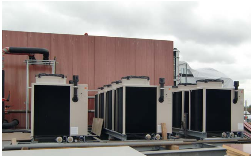
Regenerative Wärmeerzeugung über Gasabsorptionswärmepumpen
